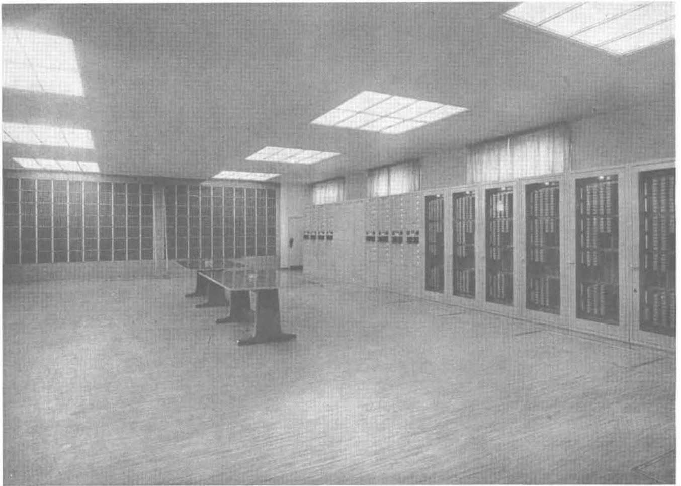
Fig. 12. — Sala centralizzata degli amplificatori delle linee entranti e uscenti e dei corrispondenti relé fonici. Sullo sfondo il permutatore a incroci.
